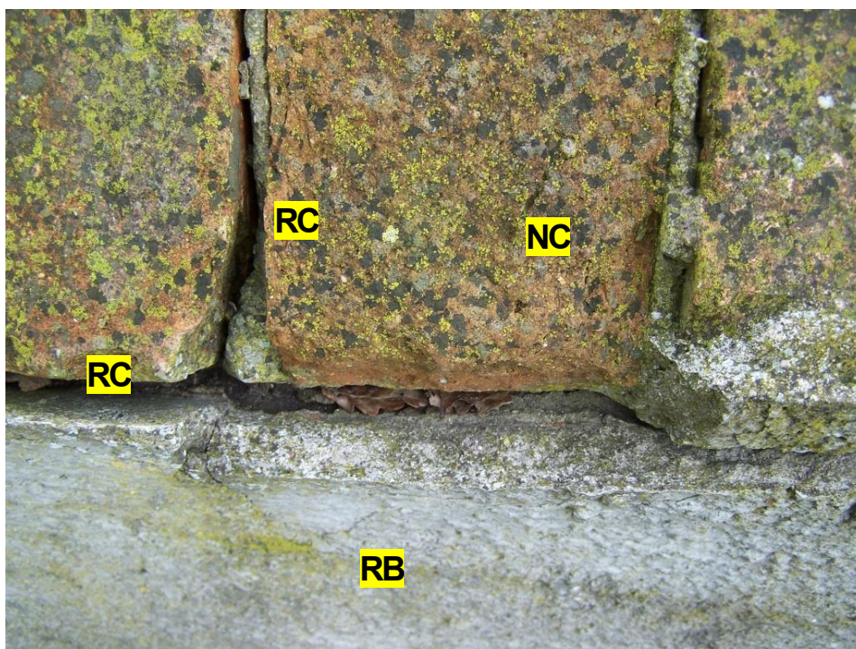
Fot. 17. Ubytki spoin w balustradzie ceglanej, zanieczyszczenie powierzchni
