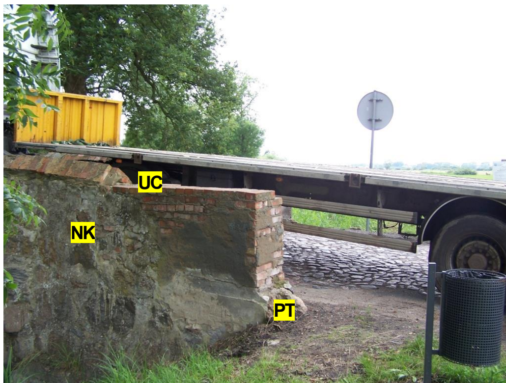
Fot. 10. Pojazd-naczepa jadący przez most w stronę Młynów (przejazd na wprost), Niedokończona naprawa zniszczonego skrzydła
